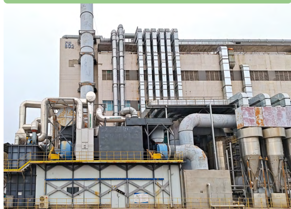
採用先進廢氣處理設施進一步降低排放濃度
