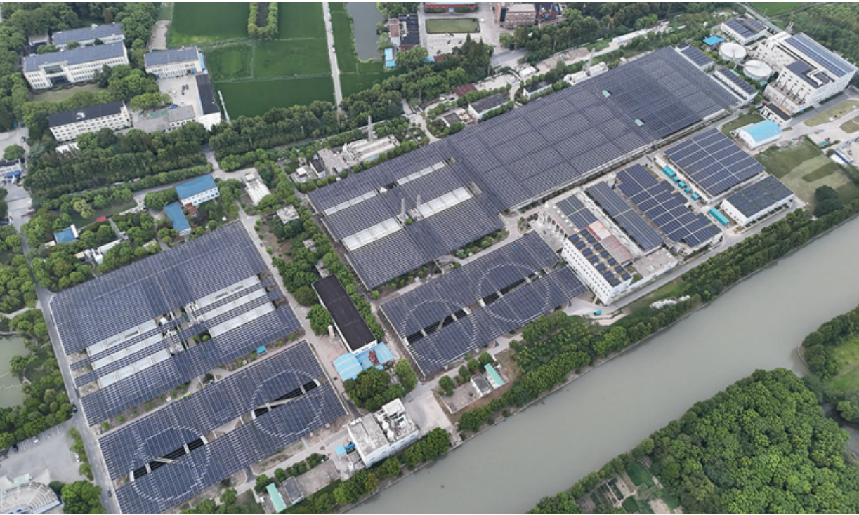
大眾嘉定污水處理廠分佈式光伏電站項目
