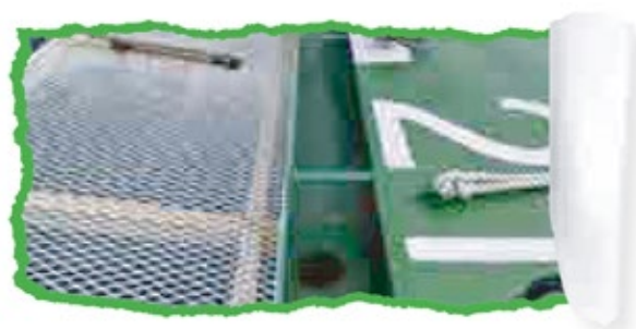
平台直升機甲板收集雨水槽
