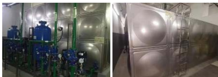
雨水回收装置
