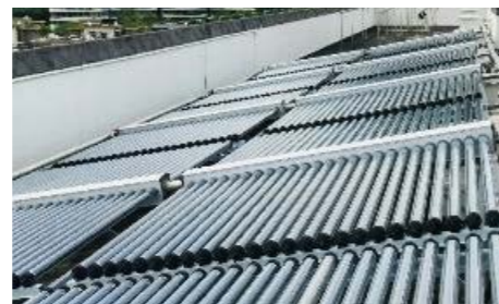
三亚瞻云精选酒店光伏铺设
