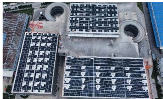
万纬武汉东西湖冷链园区屋顶光伏
