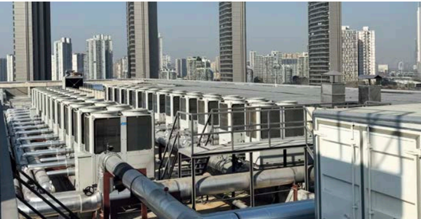
▲ 南京雨花万象天地采用空气源热泵与常规能源相结合的形式进行热源供给
