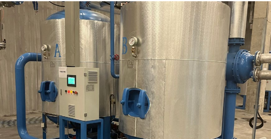
空壓機的后處理設備選擇零氣耗壓縮熱再生乾燥裝置，利用回收余熱進行乾燥機再生，節約 5%-8% 的能源
