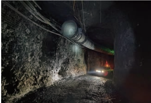
主斜坡道輔助風機
