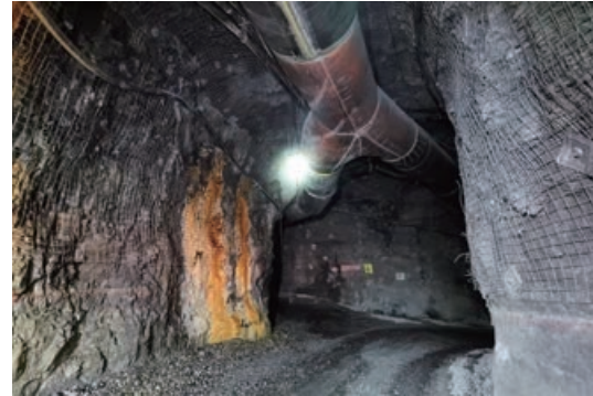
主斜坡道通風管
