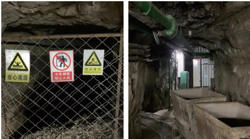
圖10-8：蓮花溝5號採區五中段集水坑及主變電站照片
