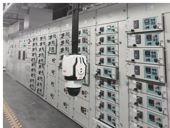
某城市軌交供電系統室內智能巡視系統
