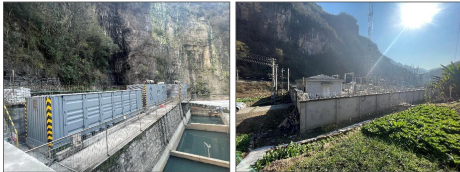
圖14-2：為魚林溪磷礦供電的鹽池變電站（右）與柴油發電機（左）
