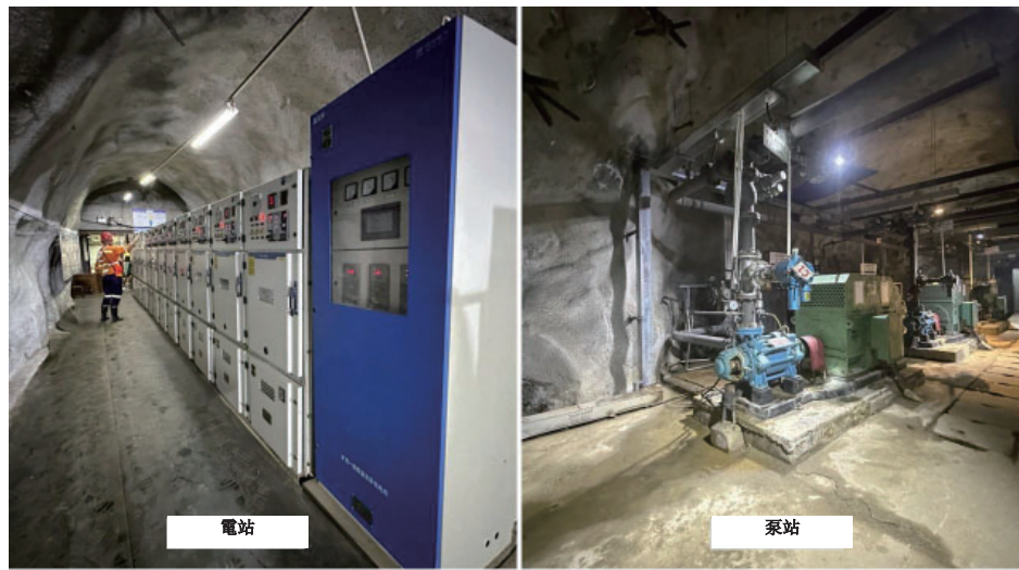
圖 16.9：-300 ASL 泵站與配電室
