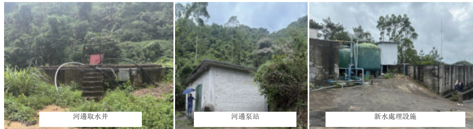
圖 17.4：NEW水取水、泵送及淨化處理設施
