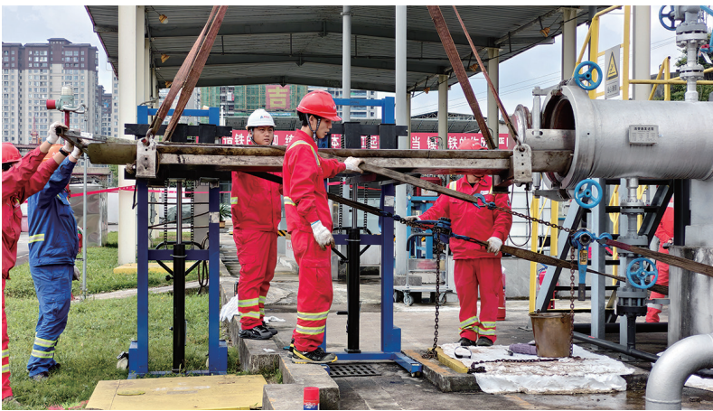
對管道發射器進行漏磁在線檢測
