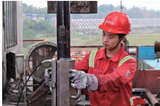
對鑽井平台進行井下油管漏氣檢測
