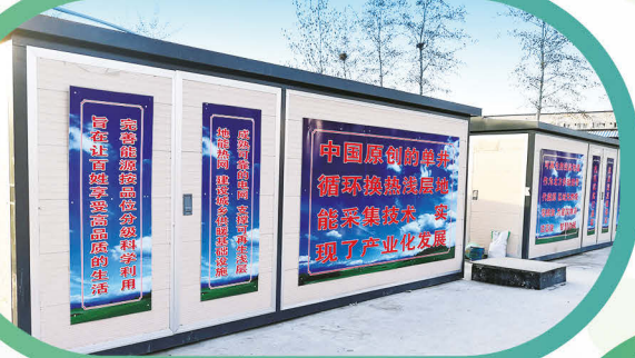
高效電替煤集中供暖機房
