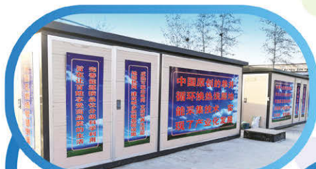
高效電替煤集中供暖機房
