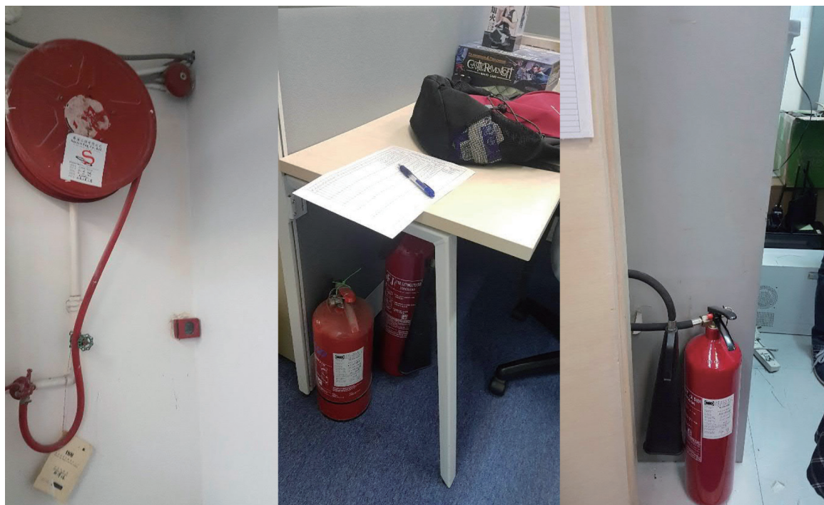
放置在辦公室及伺服器機房的消防設備
