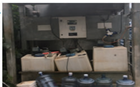
現場污水處理系統
