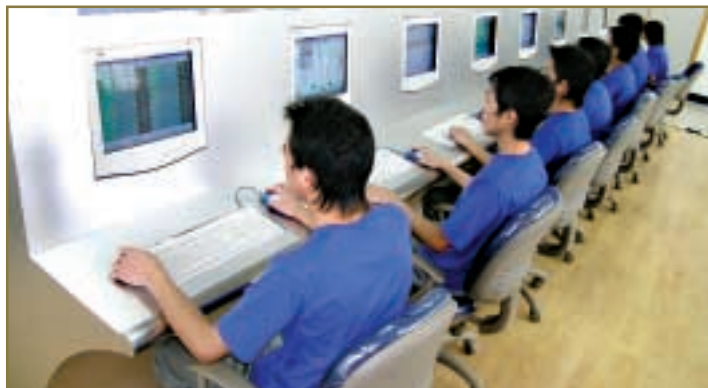
珠海工廠的控制室
