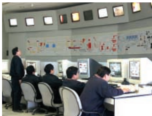
Advanced Central Control Room 先進的中央控制室
