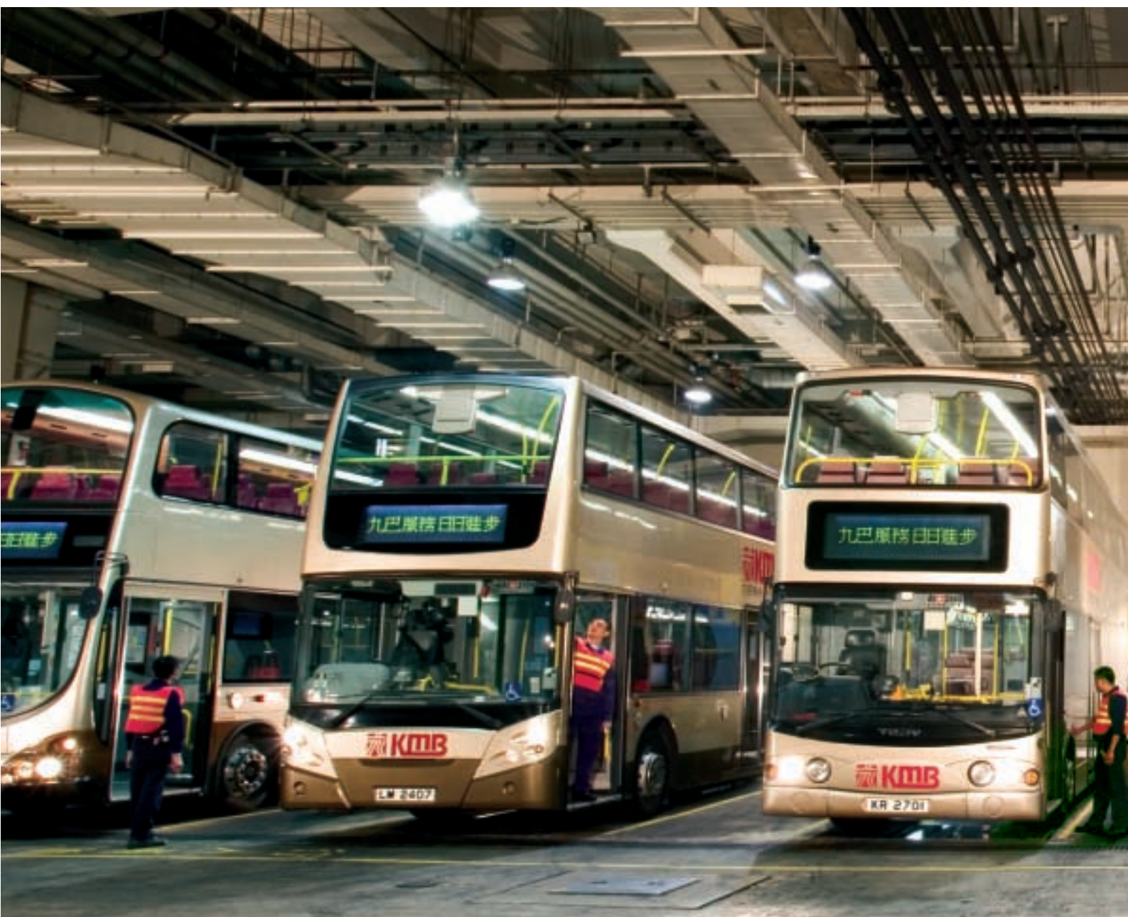
新荔枝角車廠設有最先進的巴士維修設施
