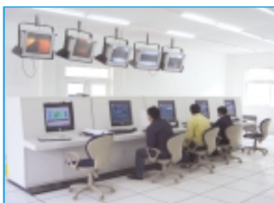
中央控制室 Central control room
