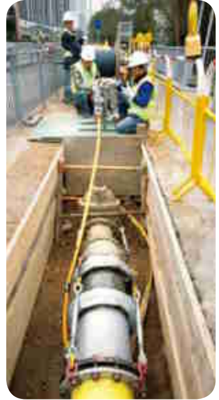
名氣通運用煤氣公司之管道發展其光纖網絡，為客戶提供「度身訂造」之基建及高頻寬服務。
