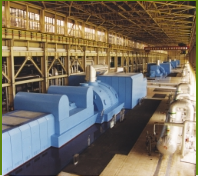
Generating Units of Shenzhen Mawan Power Co., Ltd 深圳媽灣電廠有限公司發電機組
