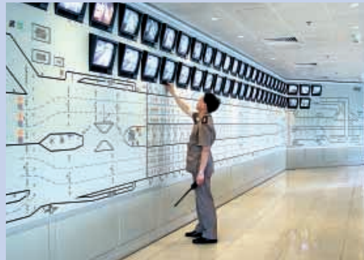
控制室內置先進科技設施監察交通流量，確保三號幹線（郊野公園段）運作暢順。
