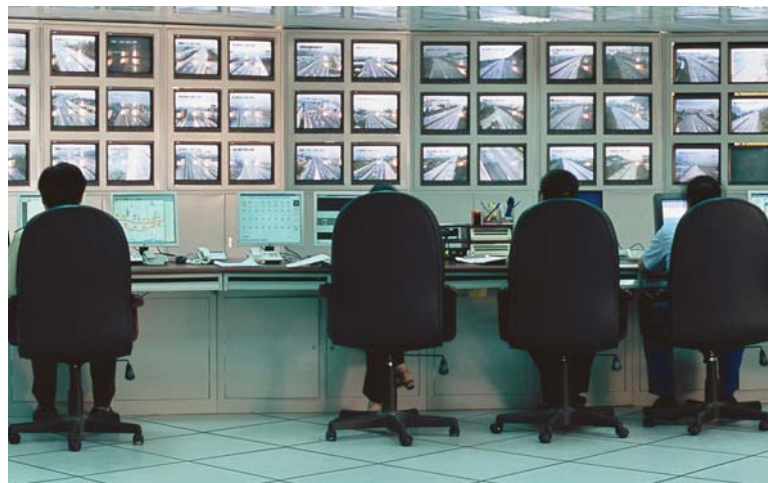
廣深高速公路交通監控中心
