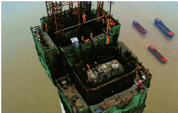
蘇通大橋索塔
