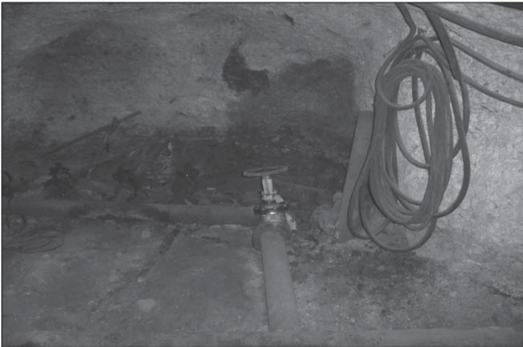
井下芒硝管道系統溶區雙道排放管
