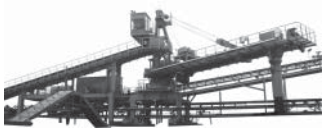
港口裝卸設備
