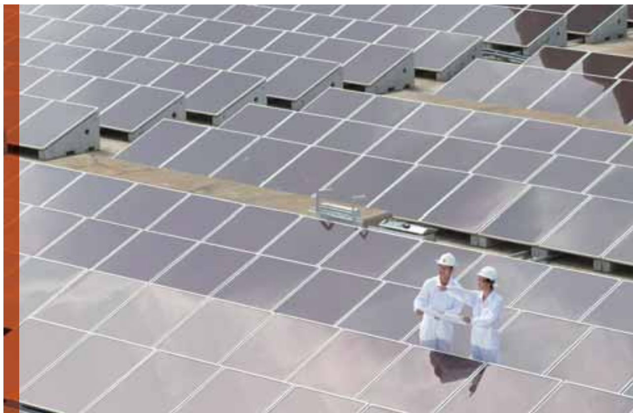
港燈於南丫島發電廠啟用全港最大的太陽能發電系統，系統由五千五百塊光伏板組成。
