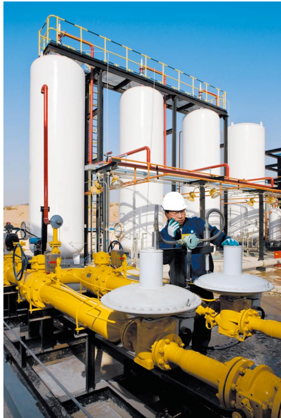
山西省之煤層氣液化廠於2011年全面投產，每年總產量可達2.5億立方米。
