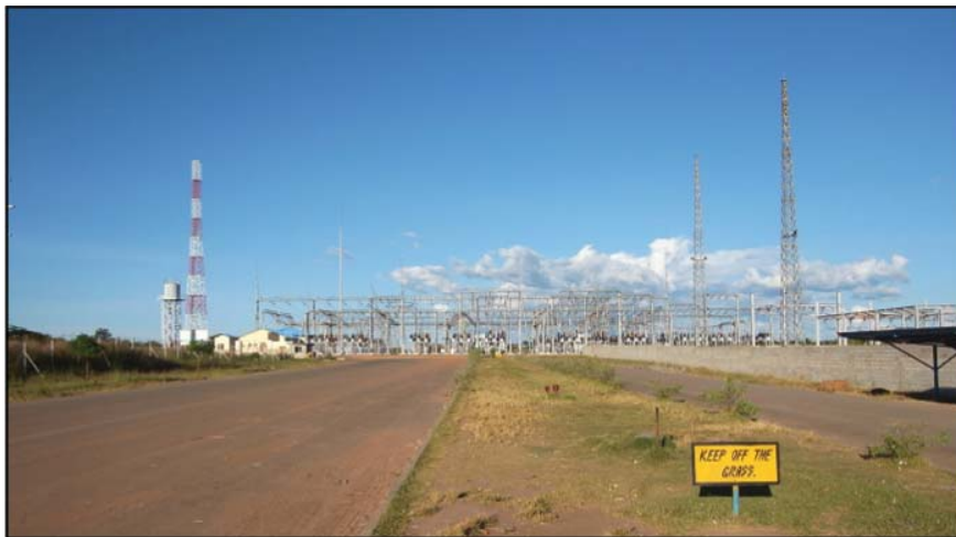
圖12-1：謙比希銅冶煉66/11千伏變電站
