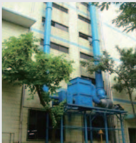
在我們其中一間工廠安裝 的碳吸收裝置
