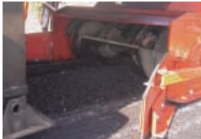
收集回收的混合料並輸送至拌拌機
