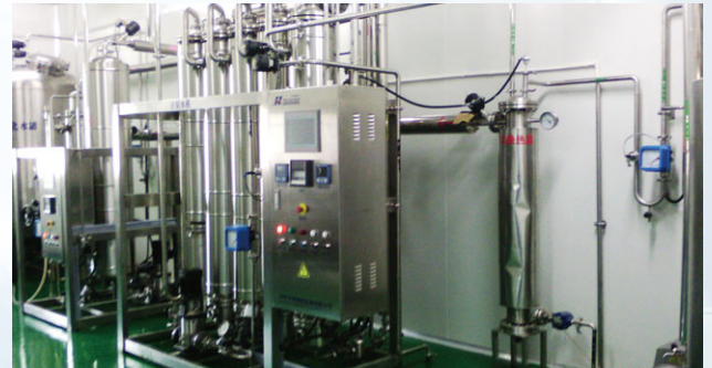
設備名稱：制造注射用超純水之系統 作用：制造注射用超純水
