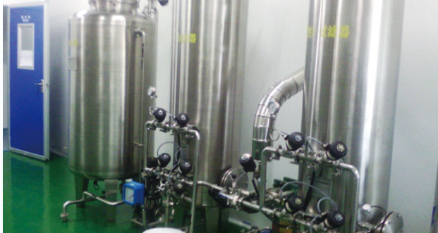
設備名稱：純水過濾系統 作用：純水粗濾
