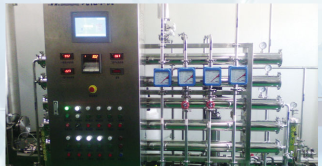
設備名稱：純化水機 作用：生產二次純化水
