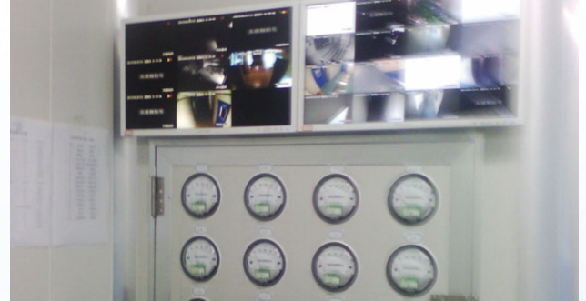
設備名稱：清潔消毒監察系統 作用：即時監察清潔消毒情況
