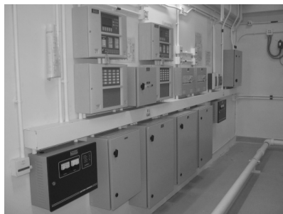
用於監控滅火系統運行的 煙烙盡系統控制板
