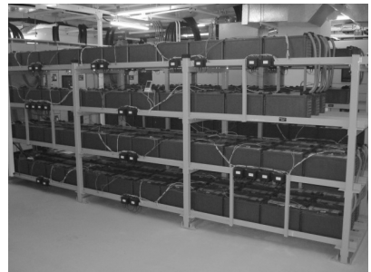
不間斷電源系統的電池
