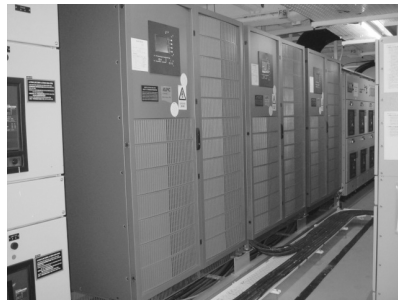
不間斷電源系統
