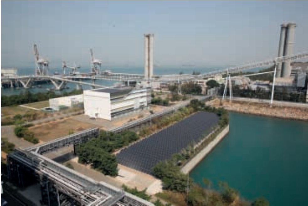
南丫擴建的薄膜光伏組件
