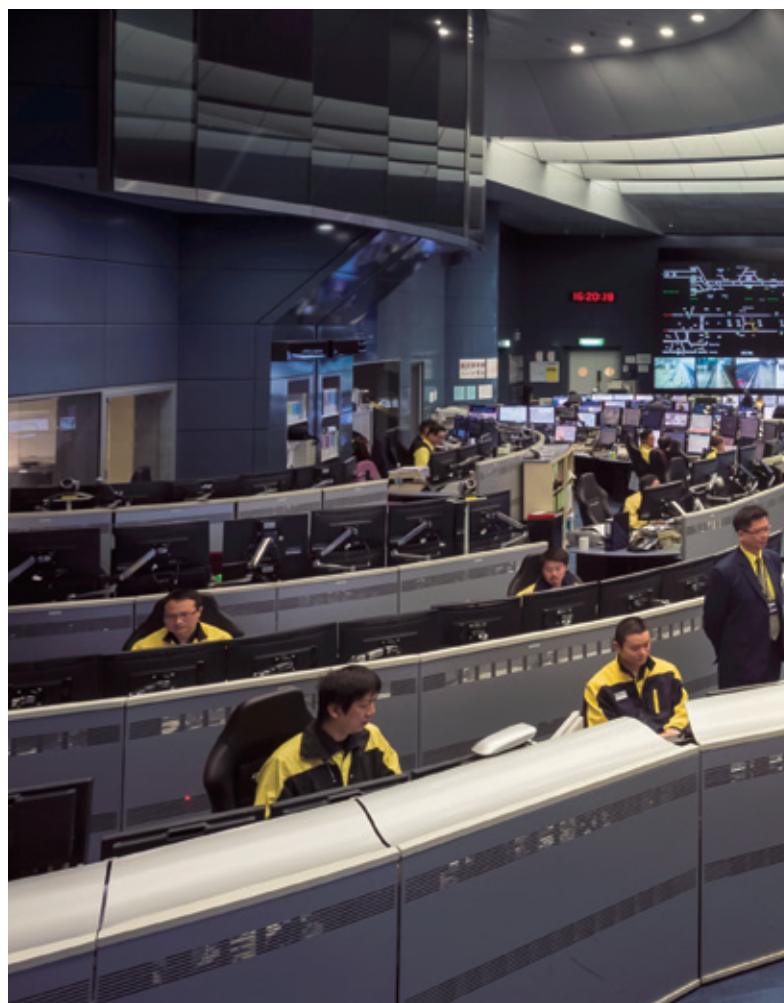
本地鐵路、過境服務及機場快綫的營運控制現由青衣「超級車務控制中心」集中處理
