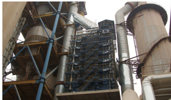
山東聯合王晁水泥有限公司之餘熱發電系統 Waste heat recovery system of Shandong Allied Wangchao Cement Limited
