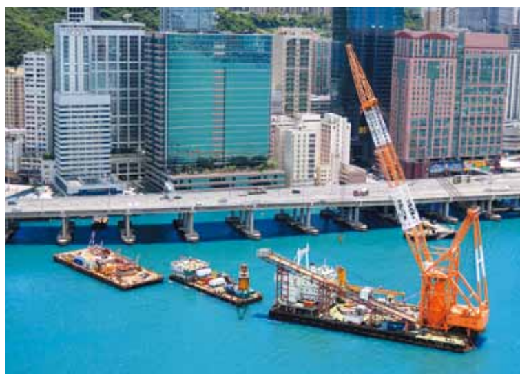
為配合政府之東南九龍發展計劃，我們為連接土瓜灣與北角之雙海底管道進行改道工程。
