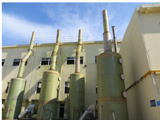
紫金山金铜矿铜湿法厂酸雾吸收塔
