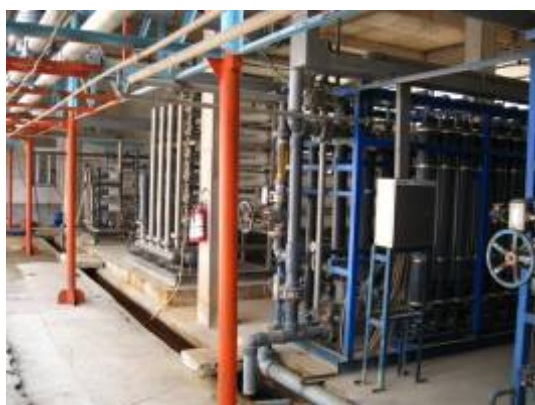
紫金山金铜矿膜处理系统
