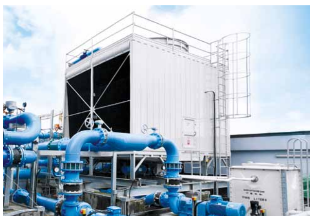
皇后大道東248號的水冷式空調製冷機組
