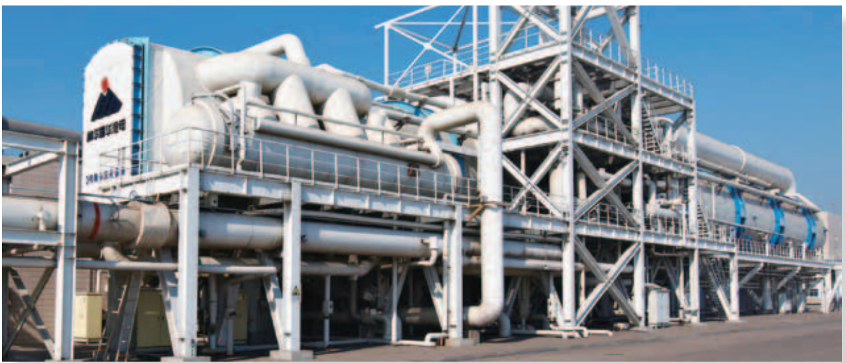
滄東電廠海水淡化設備
