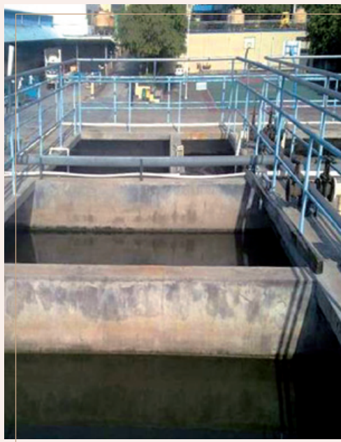
清潔水治理設施
