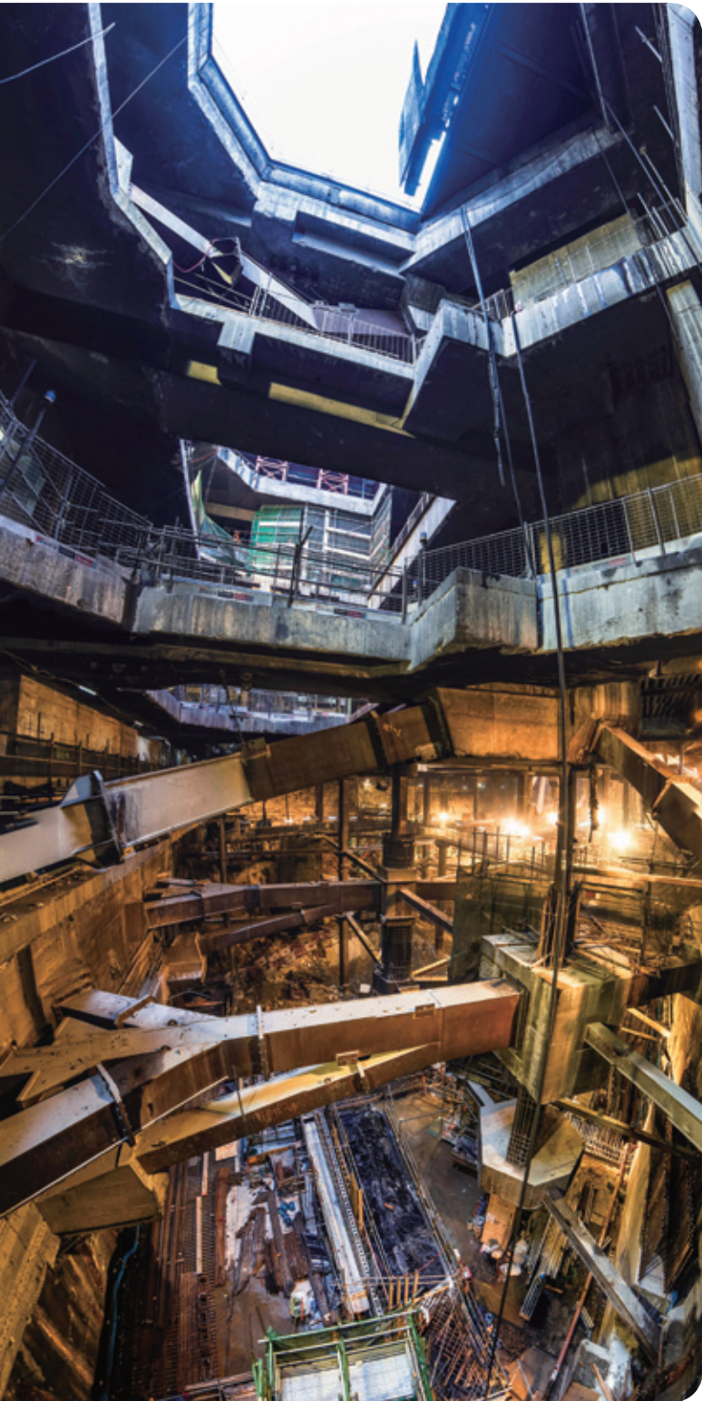
為了擴建金鐘站而需要在現有港島綫隧道下進行的支撐工程，由於技術複雜，繼續成為項目的主要挑戰
