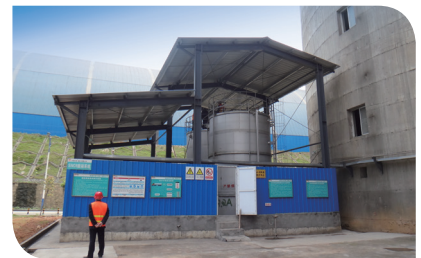
华润水泥(龙岩)有限公司SNCR脱硝系统
