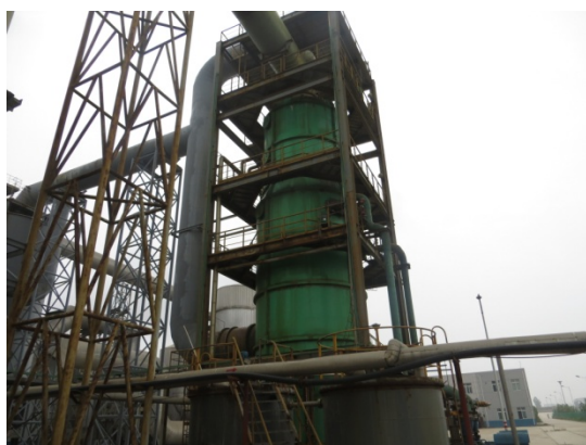
紫金青海公司制酸尾气脱硫设施
