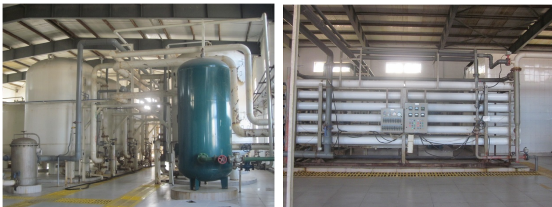
巴彦淖尔紫金有色金属有限公司废水重金属减排工程
