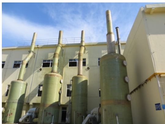
紫金山金铜矿铜湿法厂酸雾吸收塔
