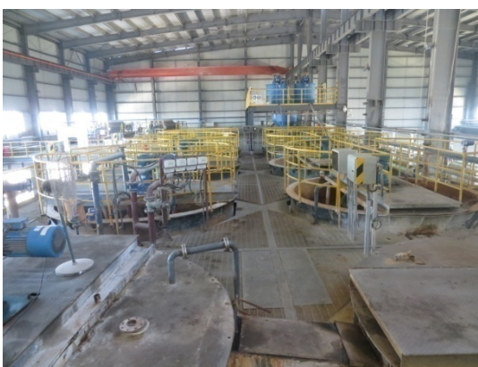
奎屯铜冠冶化污水处理系统
