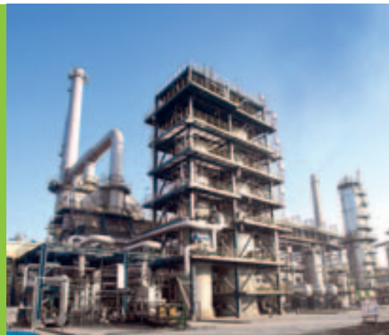
上圖：中國石化石家莊煉化分公司液相循環加氣裝置
