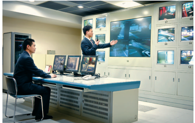
24小時保安及閉路電視監控室
