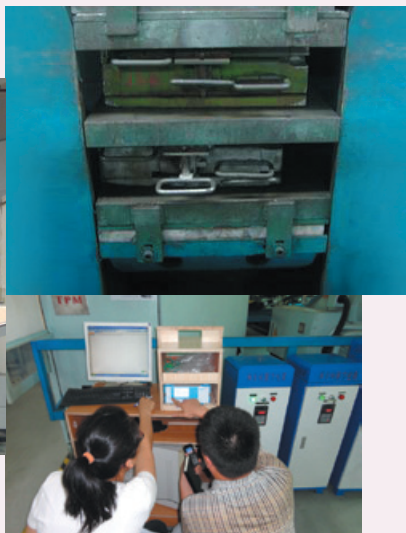
二次發泡注入機上安裝綠色伺服器
