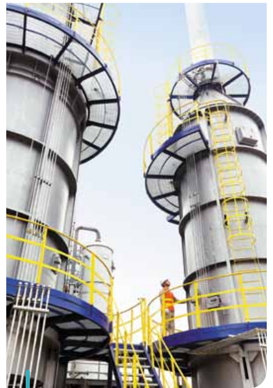
位於江蘇省徐州市之焦爐氣廠房 預計於2016年中試投產，年產量 可達1.1億立方米液化天然氣。
