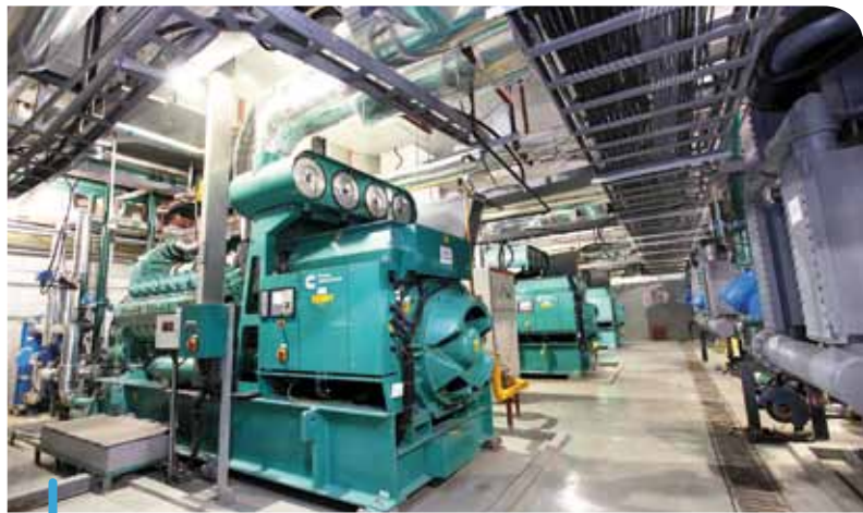
一家位於江蘇省南京市之數據中心安裝之冷熱電三聯供系統，採用天然氣為燃料，大幅提高能源效益。
