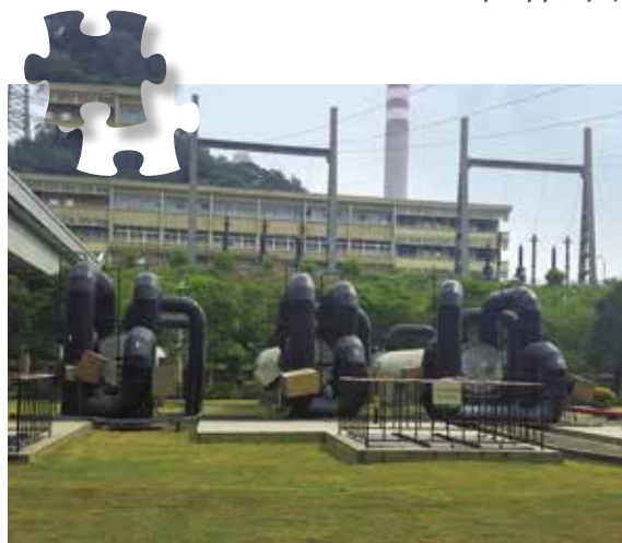
▲ 一間位於東莞市之發電廠內之蒸汽輸送管道
